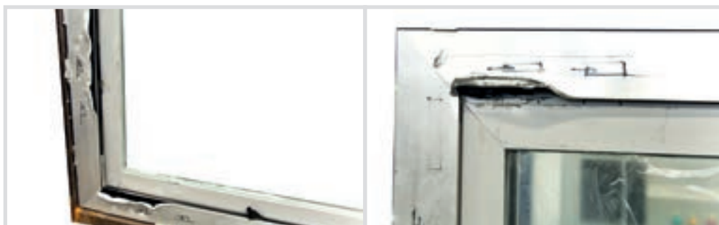
† 50 en 51 Beschadigde raamprofielen na een test op inbraakweerstand.
