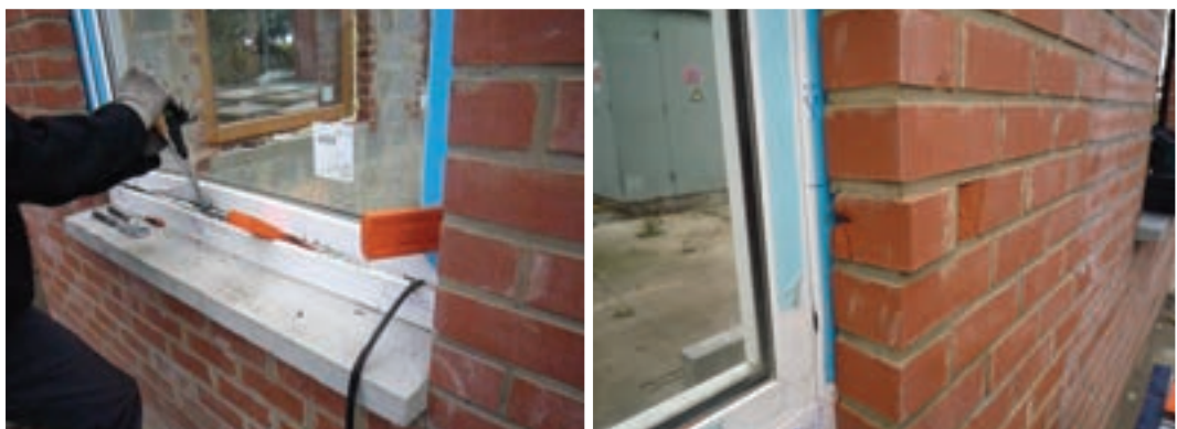
† 88 Beschadiging van de buitenmuur na een test op inbraakweerstand.
